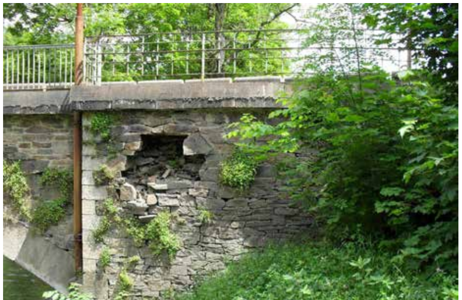
Bild 3: Schadbild Stirnwand Oberstrom
